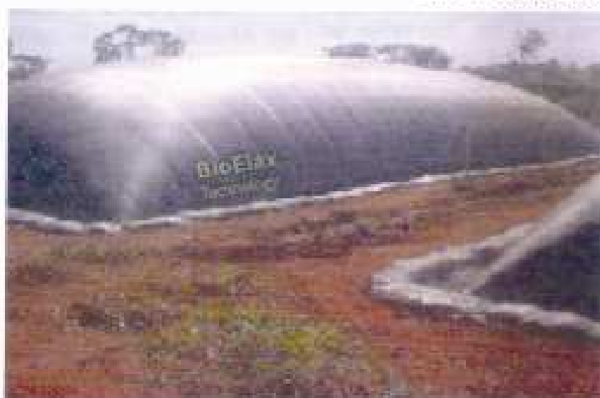
BIODIGESTOR ANAERÓBICO EN GRANJA PORCINA EN SANTA CATARINA (BRASIL) CORTESÍA DE BIOGÁS MÉXICO
