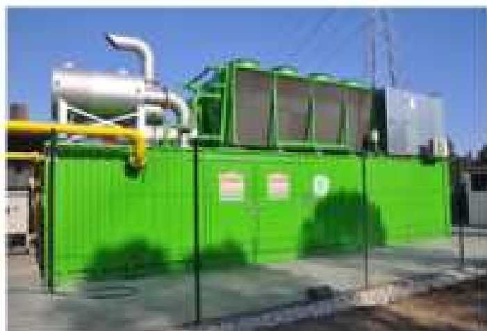
Contenedor con turbina de producción eléctrica que funciona a partir de biogás de residuos orgánicos.
